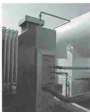
(画像5: 液体をガスに変えるコンプレッサー)
